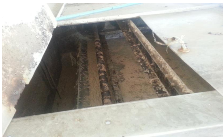
ภาพประกอบที่ 2.15 บ่อแยกไขมันจากน้ำเสีย (KWF 35)
